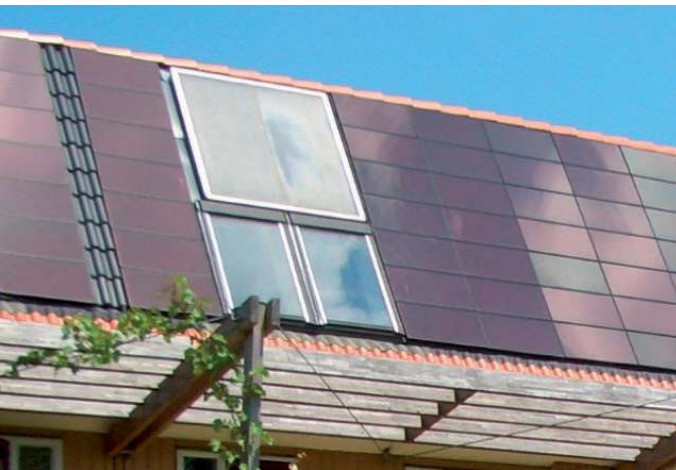
PV-panelen en zonnecollectoren
