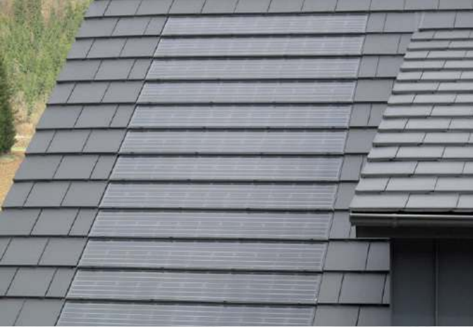
Dakpannen met bijpassende zonnepanelen.
